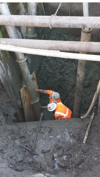
Un empleado del Departamento de Agua de Hillsboro baja para investigar la fuga de agua.
